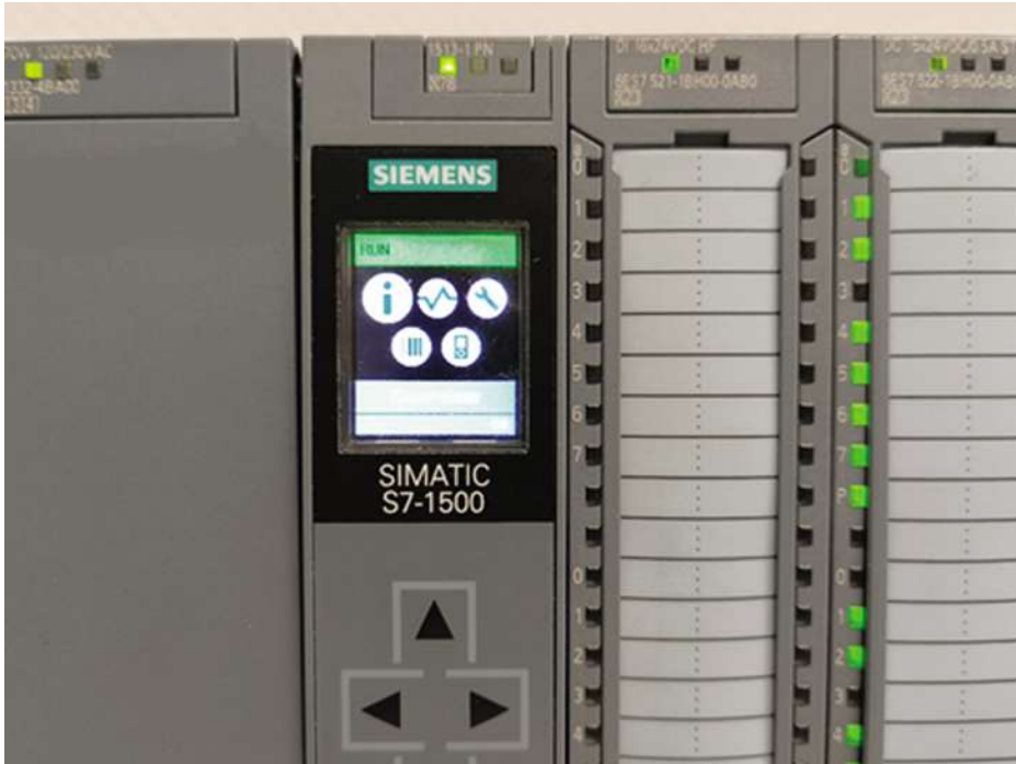
Bild 3.2 Display der S7-1500, von links nach rechts: Netzteil, S7-1500, Baugruppen DI und DO
